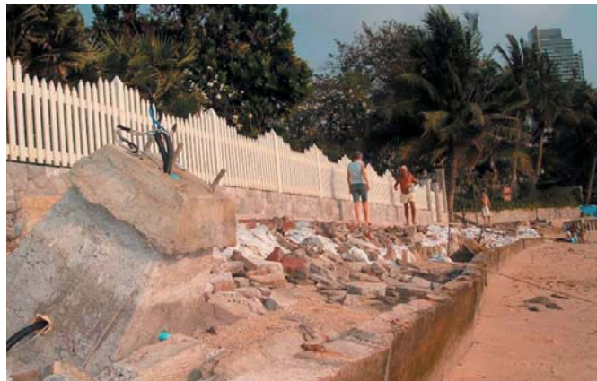
Die zusammengebrochene Promenade am Wong Amat bietet den Urlaubern einen tollen Fitness-Parcours.
